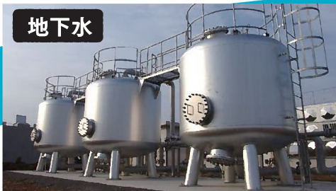
後蘭浄水場(鹿児島)[硬度低減化施設] 2,730m 3 /日
