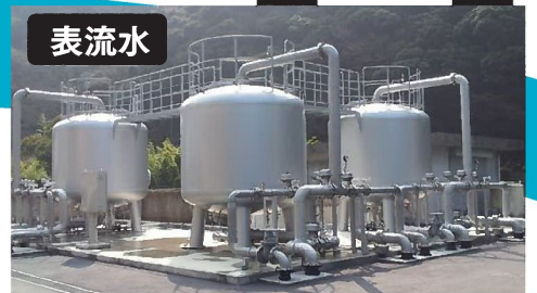
笹尾浄水場(熊本) 1,939m 3 /日
